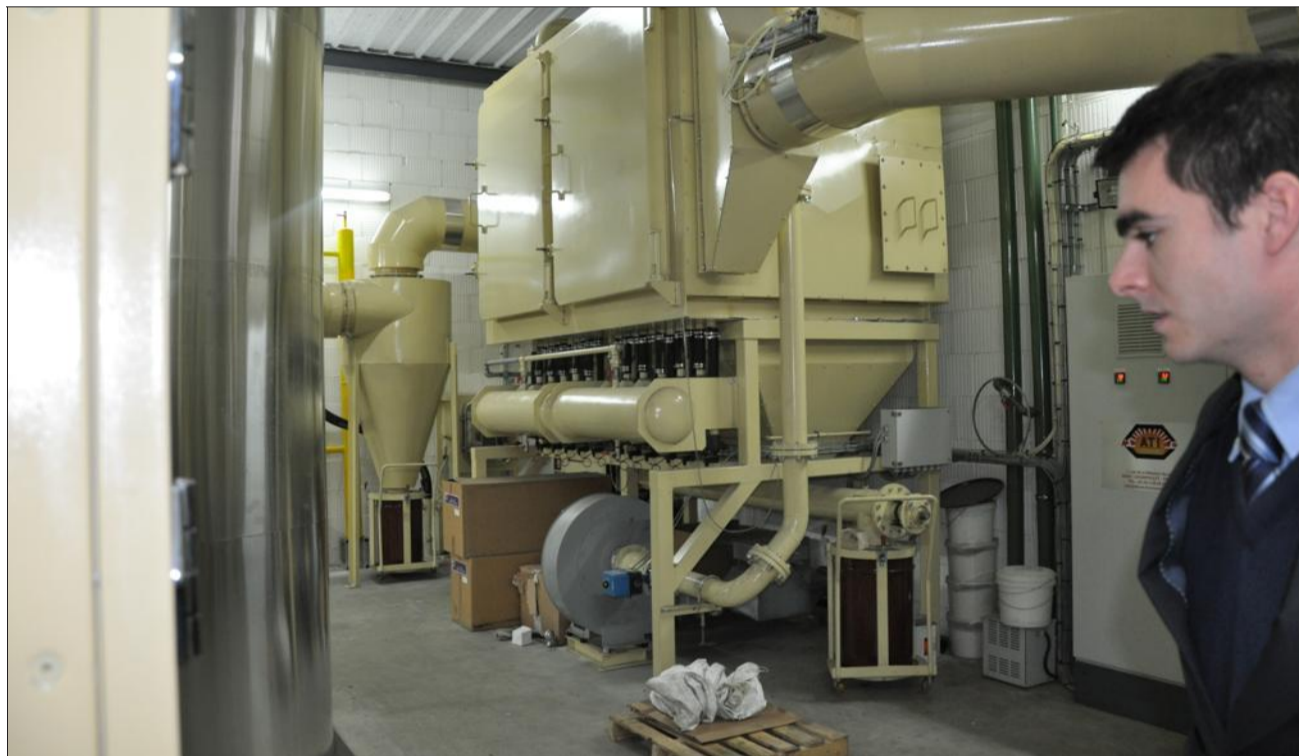
Près du four, une imposante machinerie assure le système de filtrage des fumées. Photo A.-F.B.
